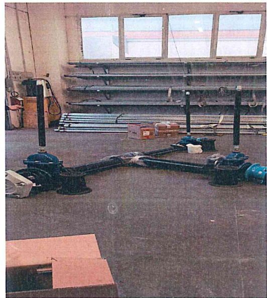
Particolare materiale idraulico da porre in opera in Via Tordino
